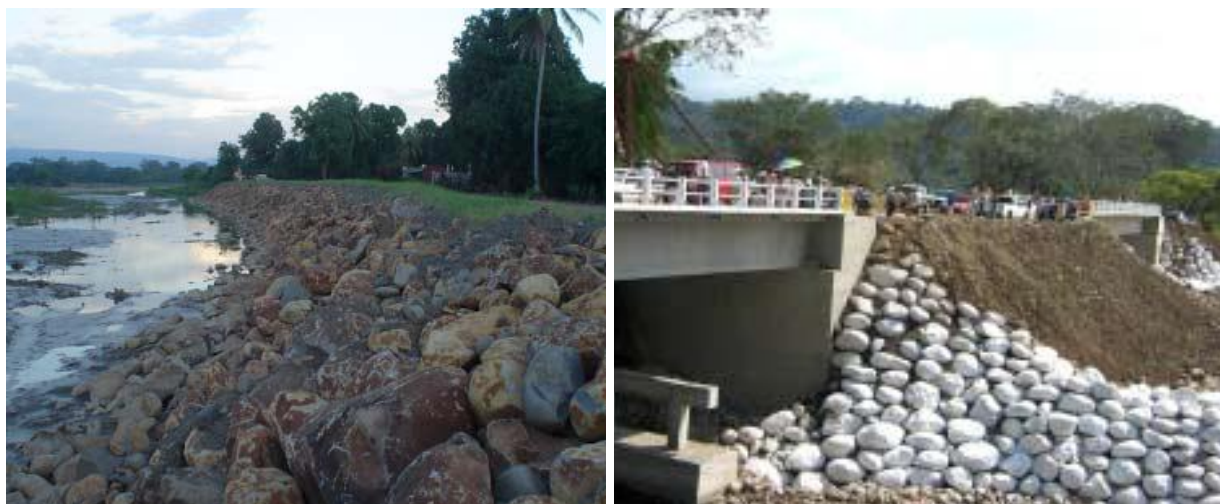
Estructuras para evitar el socavado de las márgenes de los ríos y en la entrada de las estructuras de drenaje. Izquierda: márgenes del río Los Esclavos, Santa Rosa, Derecha: Puente Cabuz II, San Marcos.
